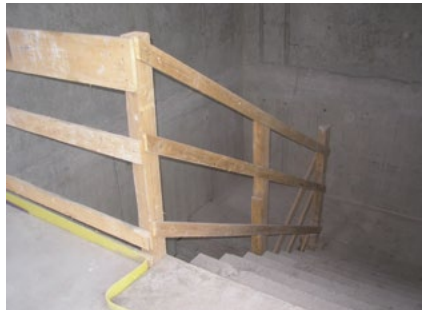
Seitenschutz an Verkehrsweg
