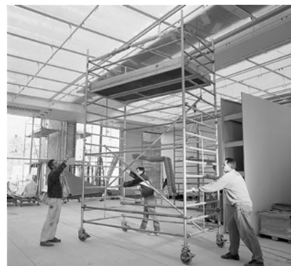
Rollgerüst nur verschieben, wenn sich keine Person darauf befindet.
