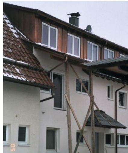
Absturzstelle aus dem 2. Stock, linkes Fenster
