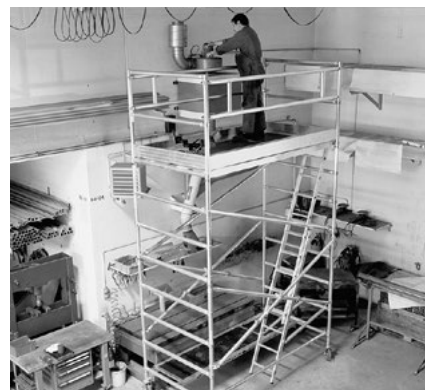
Ordnungsgemäßer Seitenschutz und sichere Rollgerüstbeläge verhindern Absturz von Personen.
