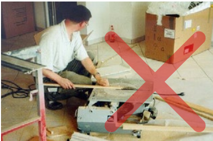
unprofessionelles und gefährliches Arbeiten
