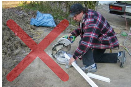
unprofessionelles und gefährliches Arbeiten
